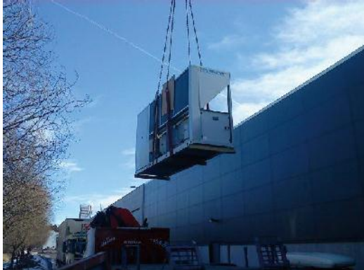
Installation av Venco aggregat Jula, Kungenskurva, Stockholm
